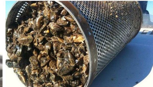
Aspecto de una tubería completamente llena y colapsada por el mejillón cebra adherido. (DN.)
